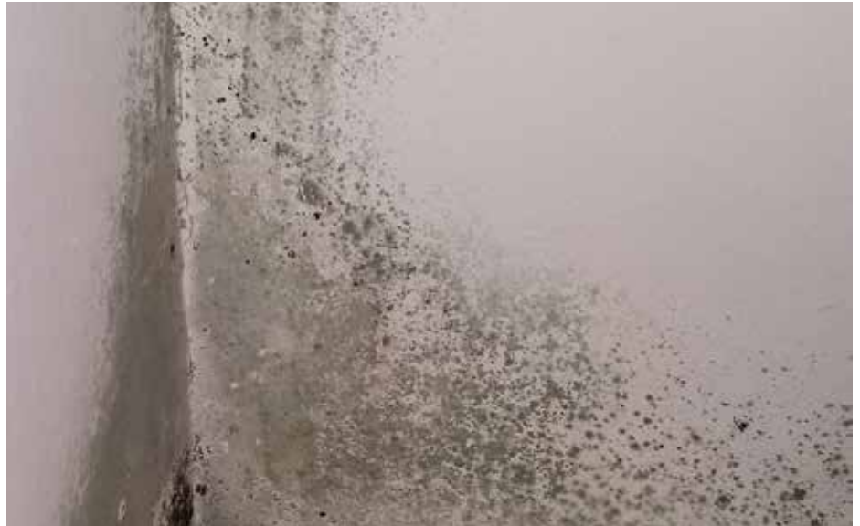
Schimmel kann die Gesundheit gefährden (Foto: Energie Tirol)
